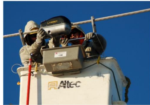
Figure 1 : Exemple d'installation d'un capteur Lindsey aux Etats Unis. CIGRE US [2]
